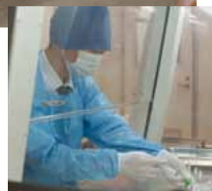
さんて薬局の調剤室を拡張して設置された無菌調剤室。ここから在宅医療への取り組みが始まった
